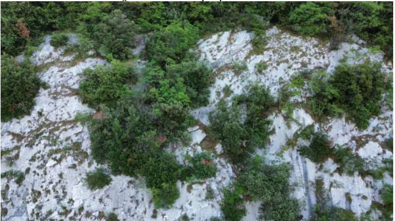
Figura 7.8 Foto con esempi di porzioni instabili
