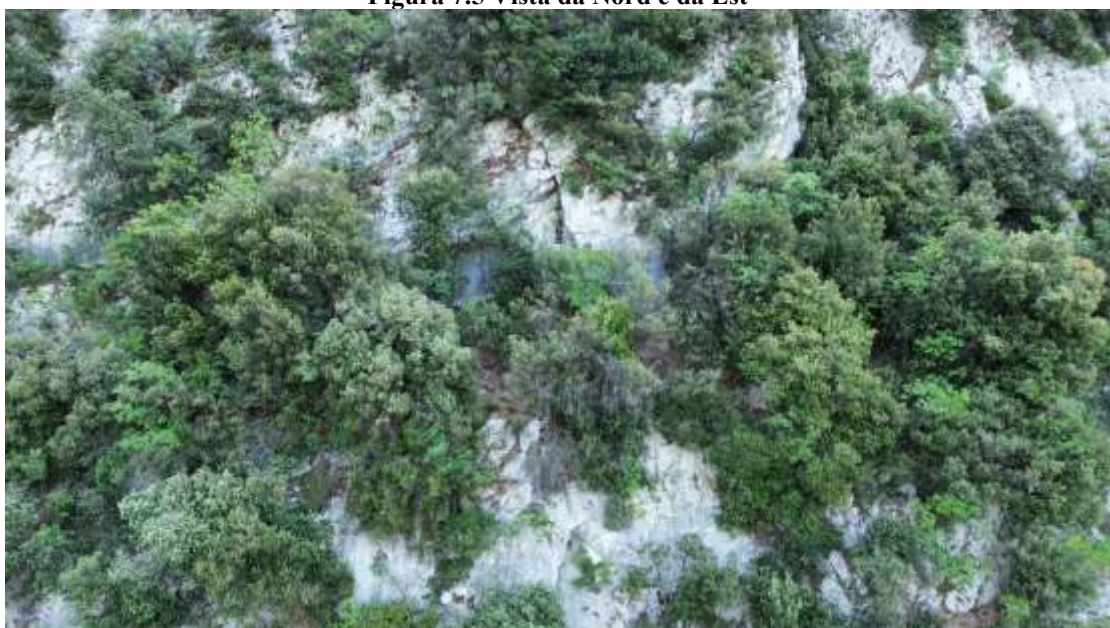
Figura 7.6 Foto con esempi di porzioni instabili
