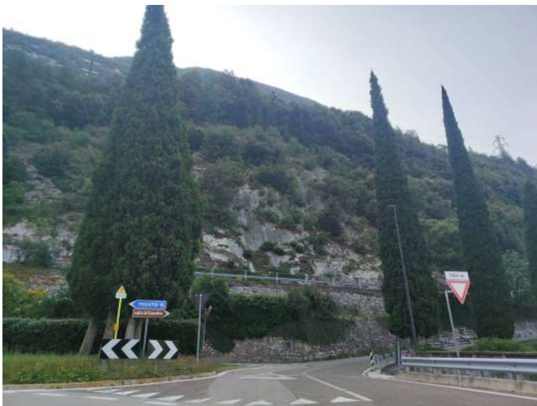
Figura 7.22 Pareti a monte della S.P.84
