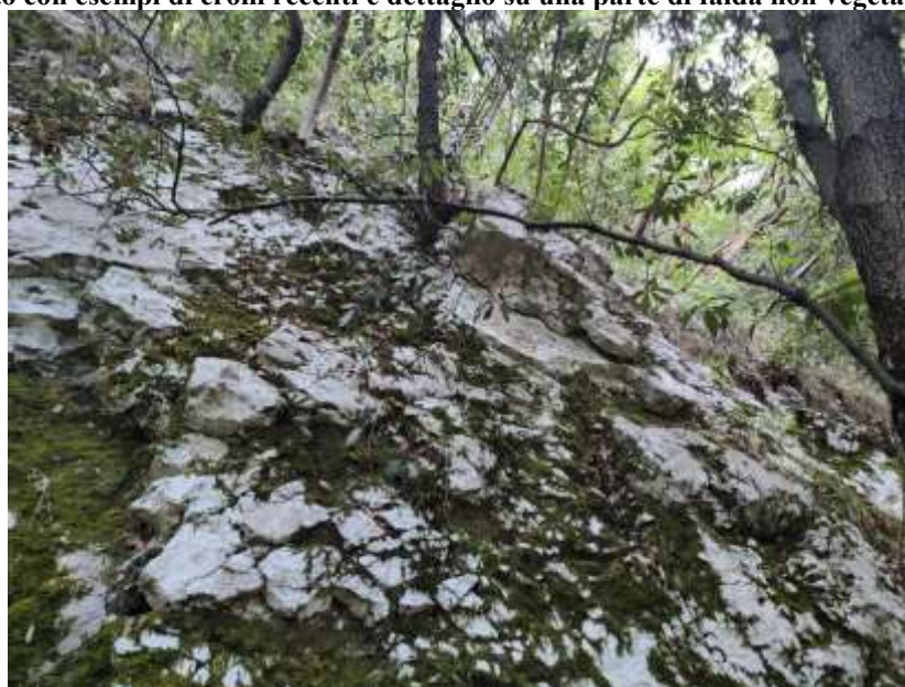
Figura 7.14 Fascia di parete a monte della P.Ed. 120. Da notare la fratturazione, la giacitura e la presenza di porzioni instabili
