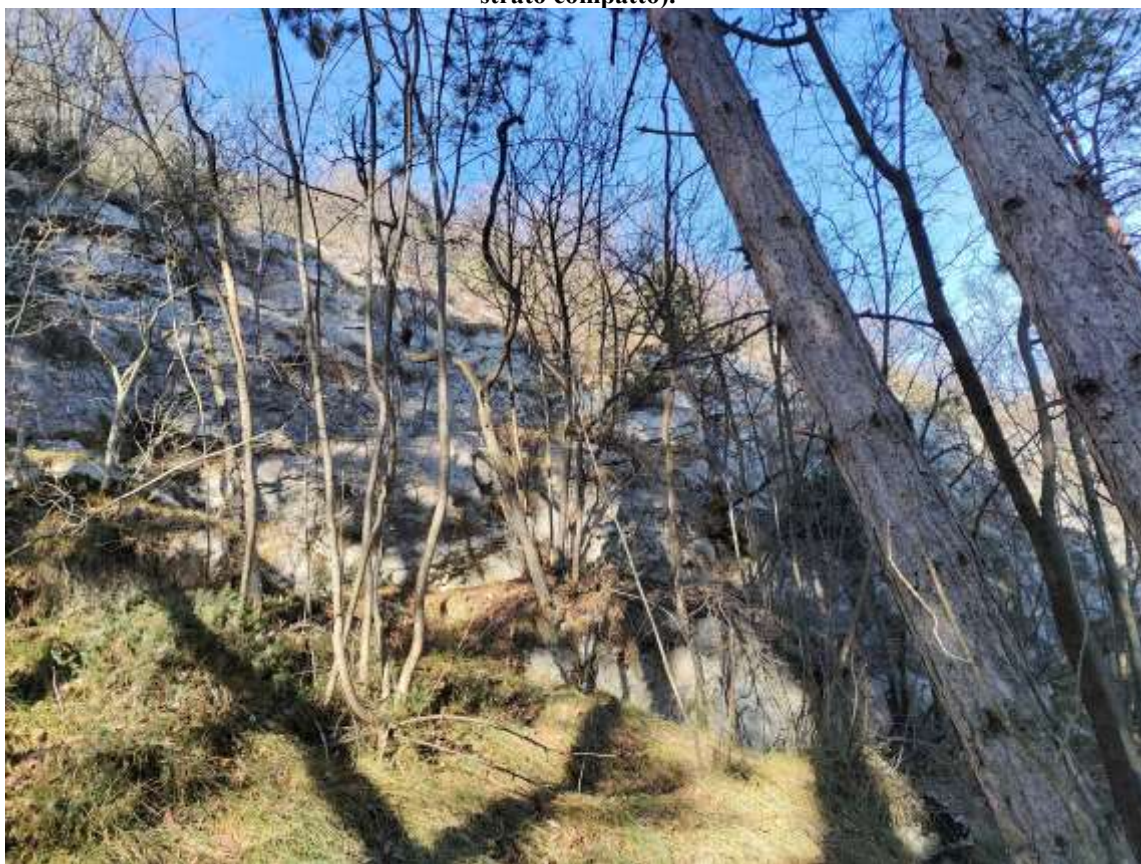
Figura 6.14 Presenza di pareti spesso appoggiate e parzialmente ricoperte
